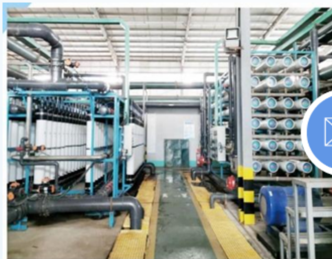
山东鲁北化工集团400吨/小时超滤+反渗透+混 床高纯水设备，出水水质符合生产用水及电厂锅 炉标准
