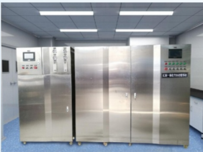
北京疾控中心500L/天实验室废水处理 (混凝加药+氧化+生化+微滤+膜法)
