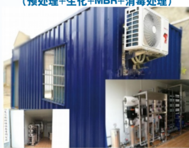
中煤项目100吨/天脱硫废水设备, 膜法处理工艺
