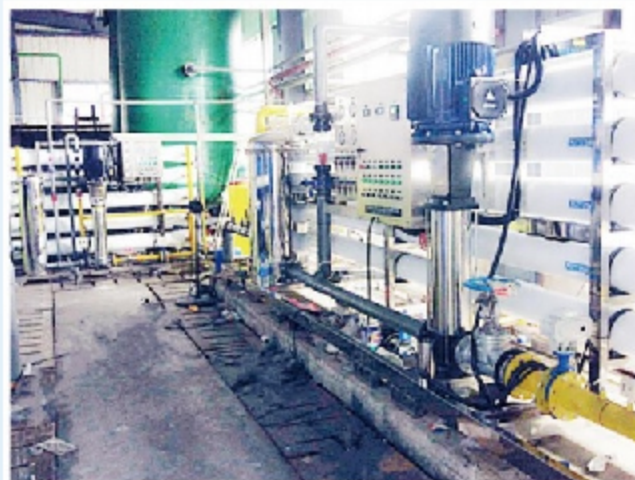
龙跃橡胶集团50吨/小时反渗透+浓水回收装置，满足生产及排放要求
