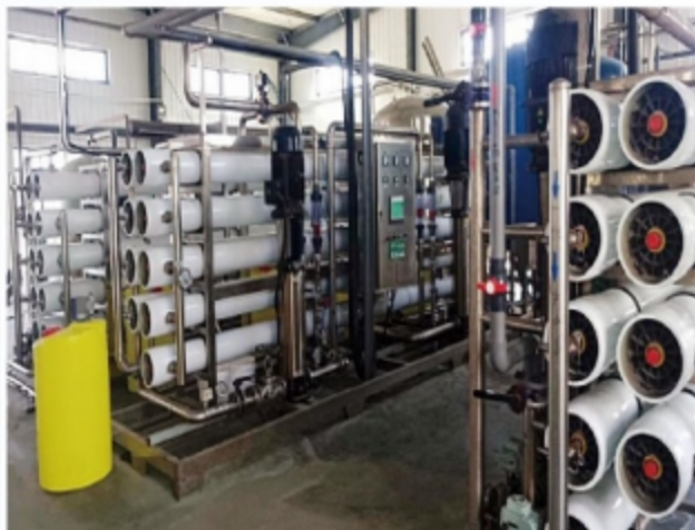
河南制药集团3*20吨/小时 双级反渗透纯水设备
