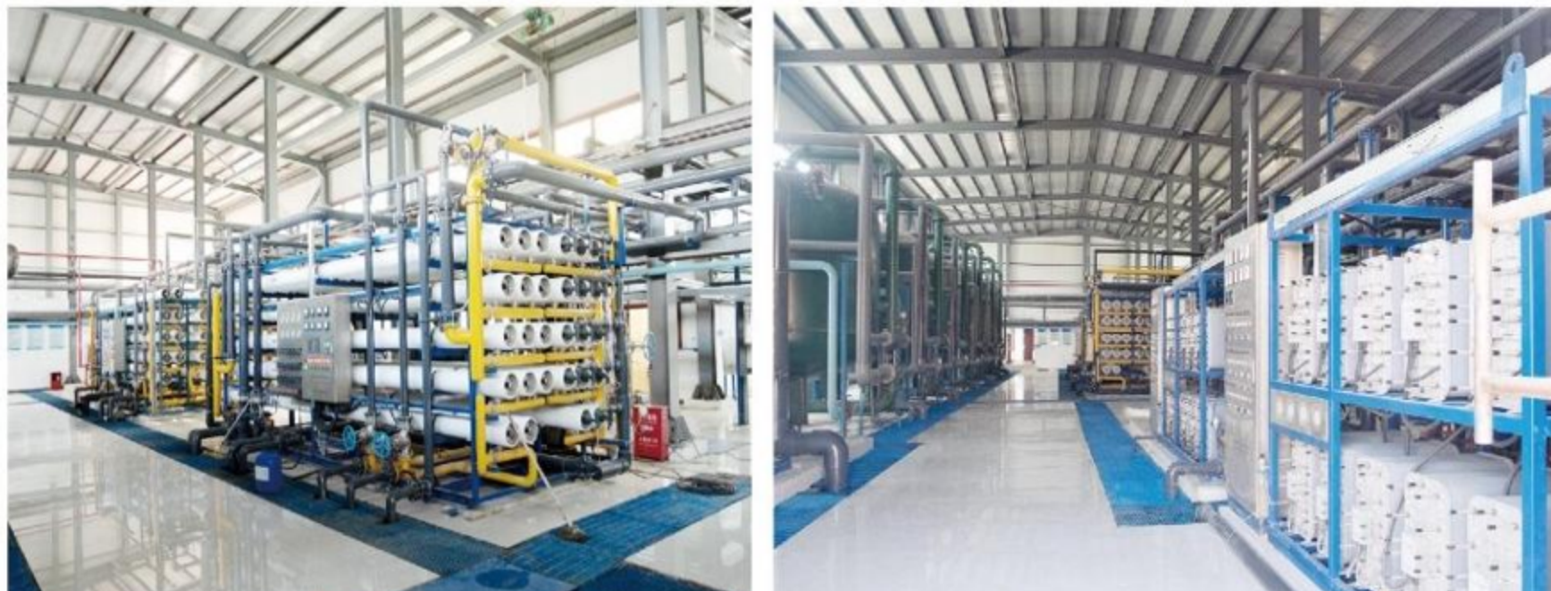
宁夏宝瑞隆石化2*50m³ 除盐水处理设备+2*50m³ 超滤水处理设备
