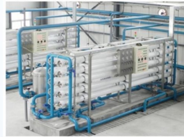
兖州煤矿7*70吨/小时纯净水系统
