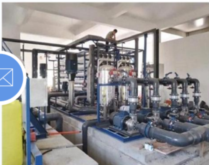
沧州市政南皮县污水厂3万吨/天MBR +纳滤+中水回用设备
