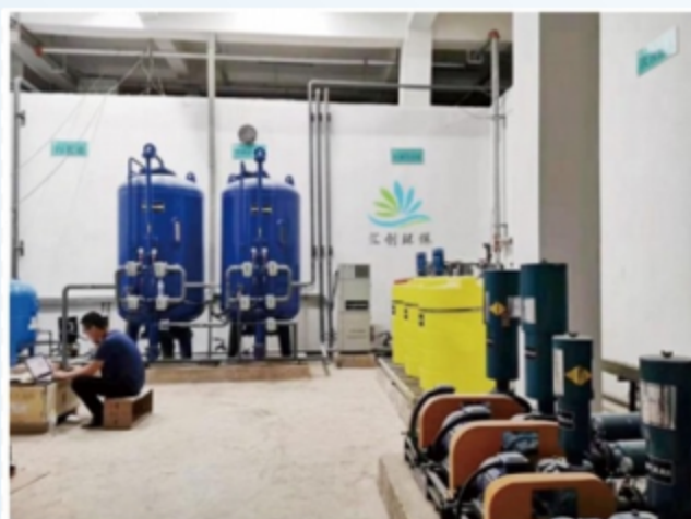
廉政教育中心300吨/天生活污水处理+回用设备(厌氧+过滤+消毒+供水)
